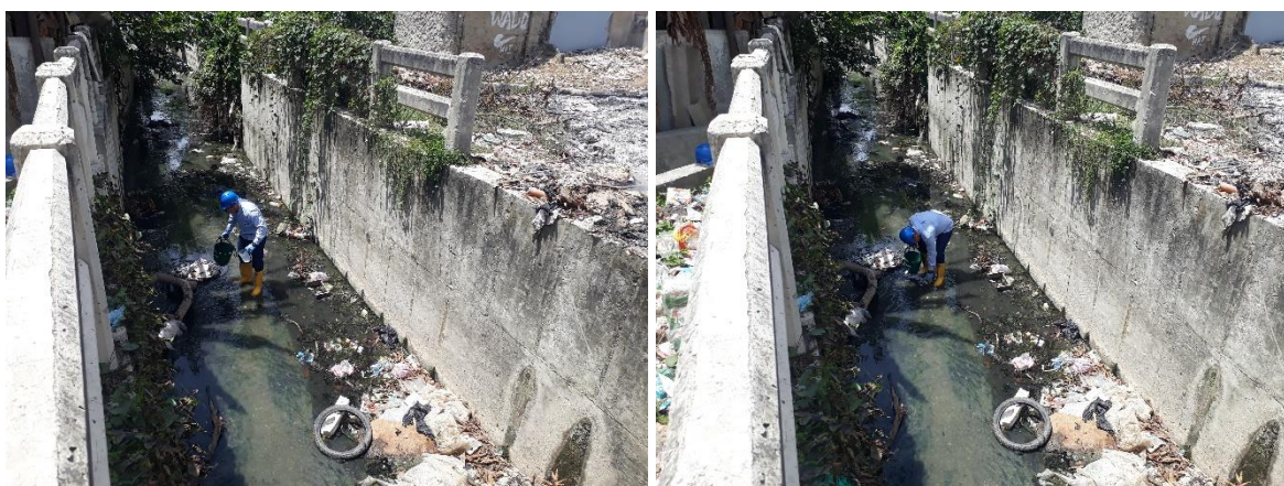
Fotografía 4-5. Carrera 26 Calle 27 presencia de vegetación y material flotante.
